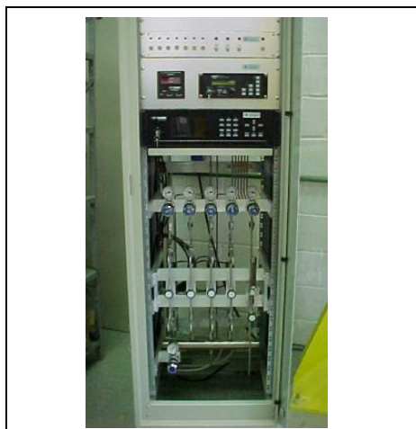
Figura 3. Gabinete de controle e distribuição de gases utilizando controladores de massa e controle de pressão com válvula borboleta.
